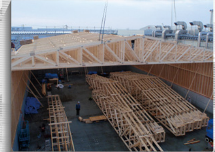
2014年に提案した「調料倉庫」で、22.75mの大スパンを実現しました。建築地は宮城県石巻市で、東日本大震災の復興事業でもあります。
